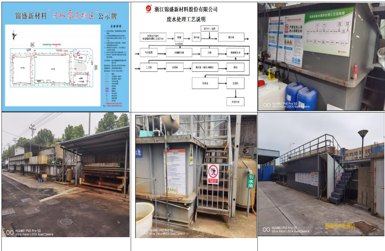
公司内废水处理设施
