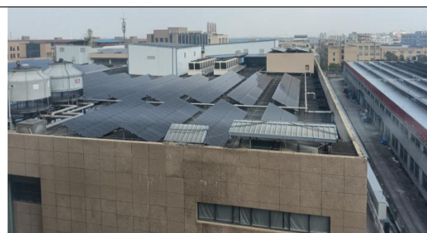
公司屋顶太阳能（光伏）
