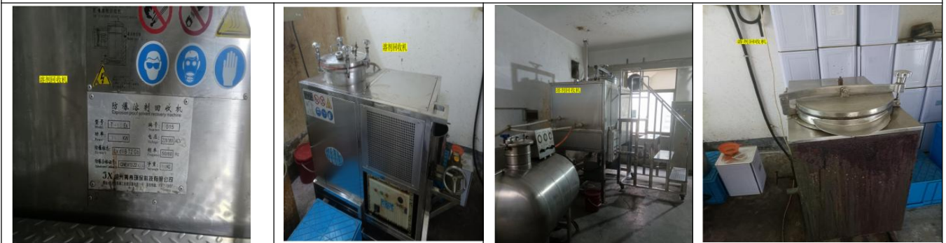
有害废弃物收集 (溶剂回收)
