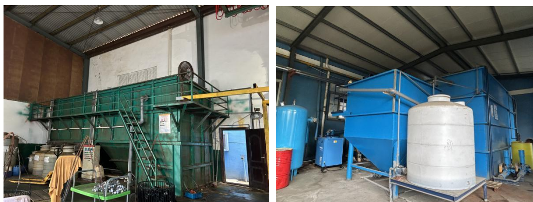
发黑线废水污水处理站
