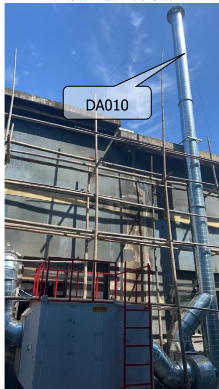
活性炭吸附装置和制浆废气排放口 DA010
