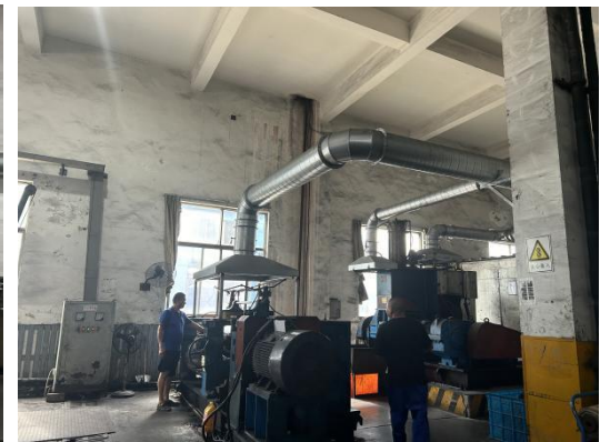
炼胶废气集气罩及收集管道
