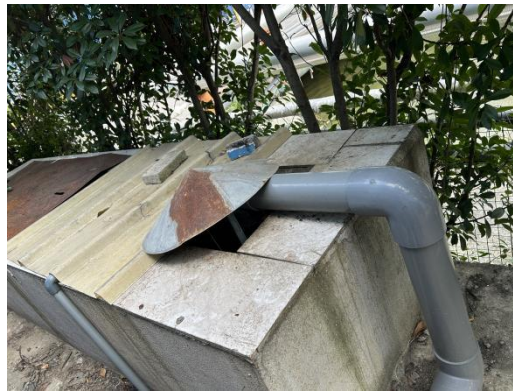
污水总排放口
