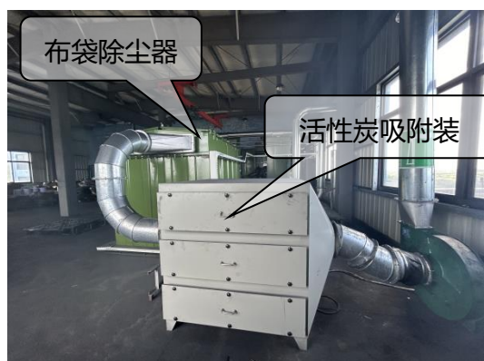
投料及混炼废气收集管道及布袋除尘器+ 活性炭吸附装置
