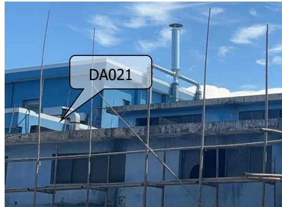
油烟净化器及排气筒 DA021
