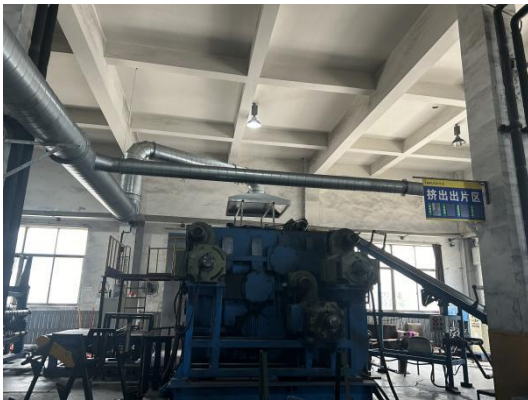
炼胶废气集气罩及收集管道
