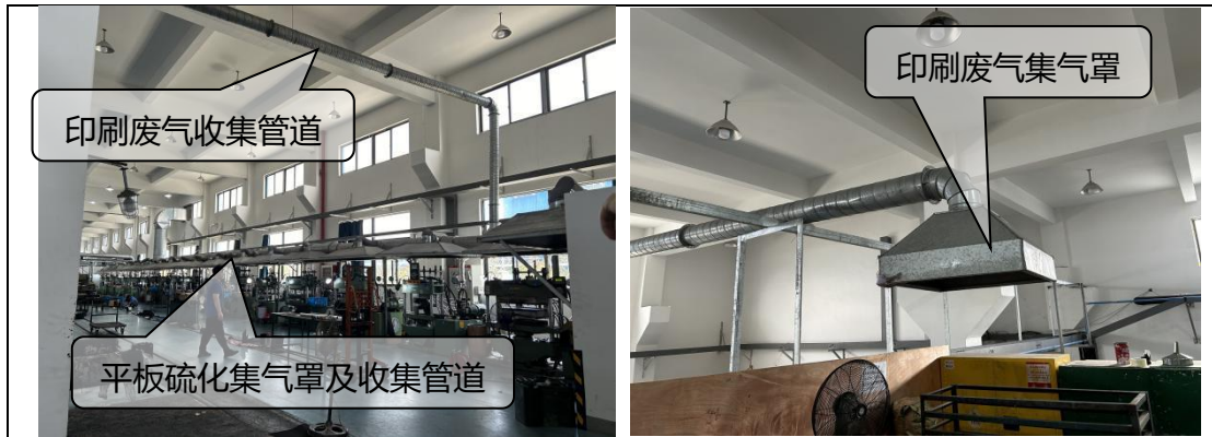
平板硫化、印刷废气收集管道
