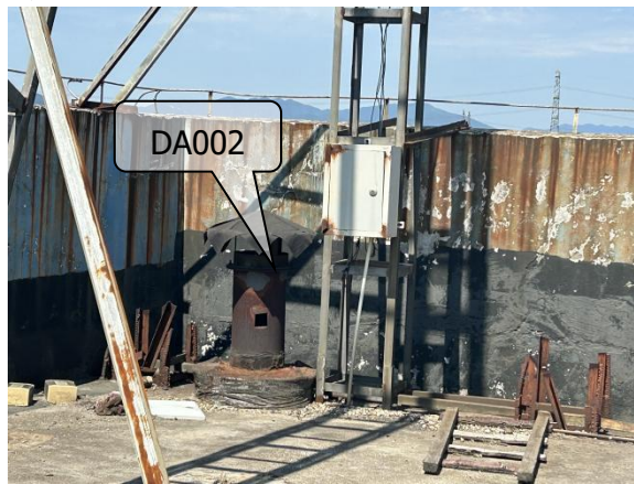
5#厂房 3F 配料粉尘排放口 DA002
