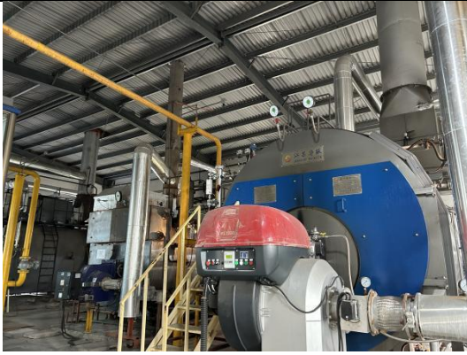
天然气锅炉废气管道
