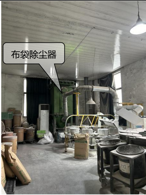
5#厂房 2F 配料粉尘收集管道及布袋除尘器
