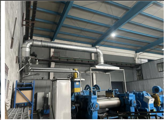
炼胶废气集气罩及收集管道
