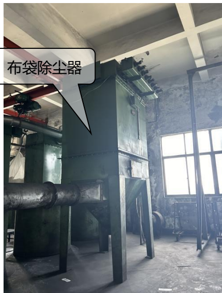
投料及混炼废气收集管道及布袋除尘器
