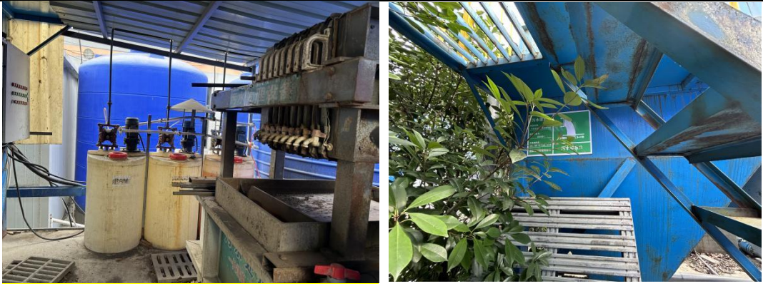
综合废水污水处理站
