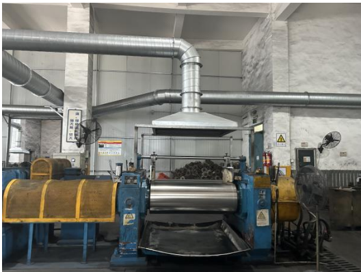
炼胶废气集气罩及收集管道
