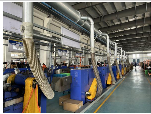
磨削废气收集管道
