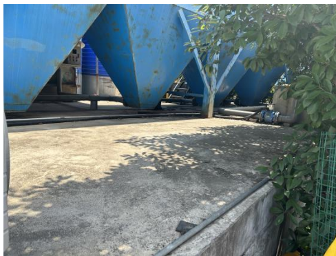
应急事故池（地下）
