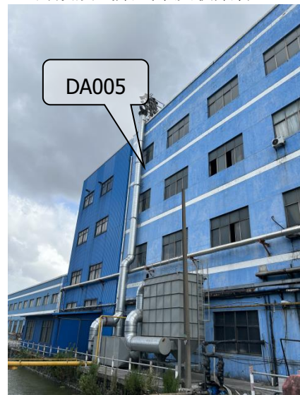
布袋除尘+活性炭吸附装置及 DA005
