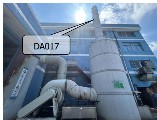
碱喷淋+水喷淋处理装置及排气筒 DA017
