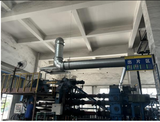
炼胶废气集气罩及收集管道
