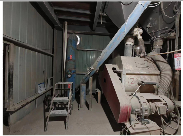
砂浆输送、搅拌除尘器
