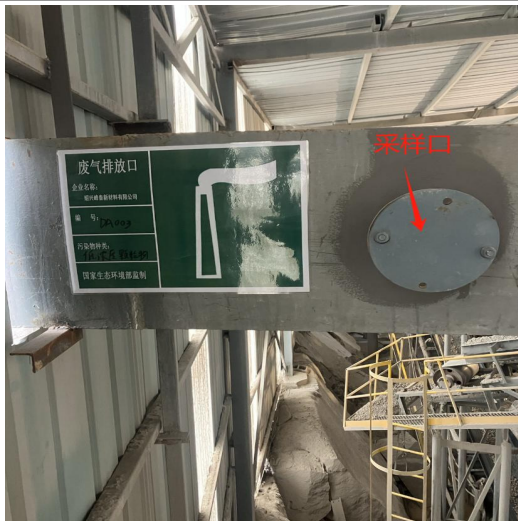
废气排放口标牌、采样口
