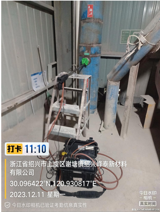
砂浆搅拌废气出口
