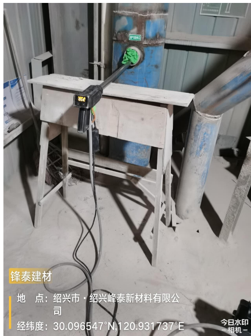
破碎除尘器 1#出口
