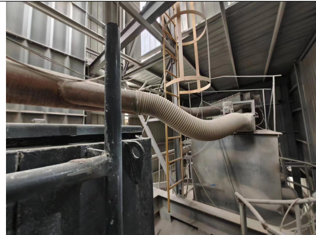
储罐顶部除尘器
