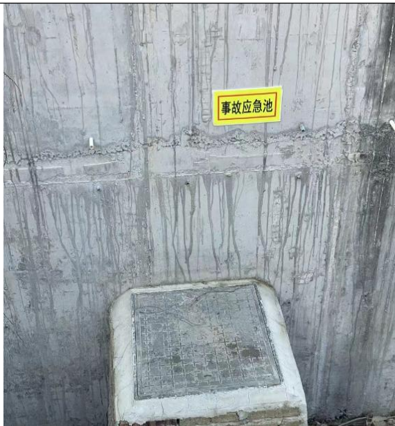
地埋式事故应急池
