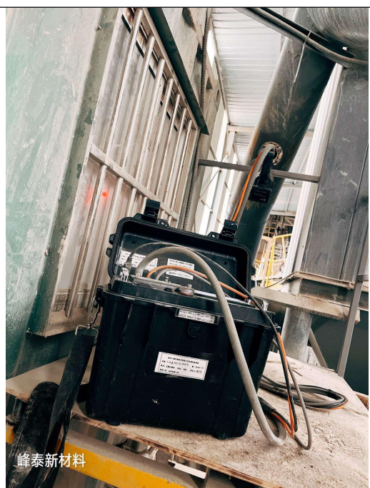
破碎除尘器 2#出口
