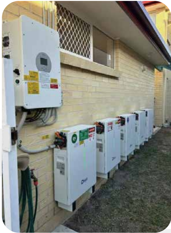
► Inverter: 10kW SUN-10K-SG02LP1-AU ► Battery: 50kWh RW-F10.2*5 (pcs)
